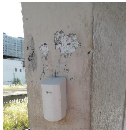
Figura 5.38 SuperVia – Estação Penha – 27/01/2021
